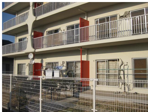
写真 1 7 非構造壁のせん断破壊
