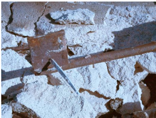
写真 1 1 落下した A L C 版外壁の取りつけ
