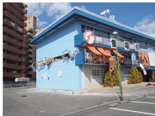
写真7 2階部分の倒壊
