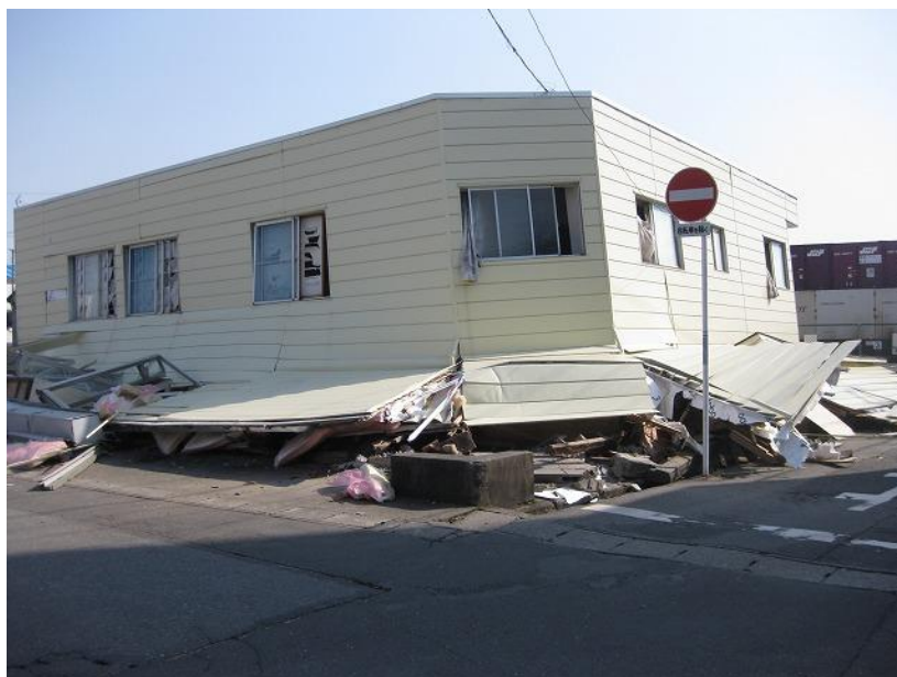
写真 9 2階建て木造店舗併用住宅の倒壊
