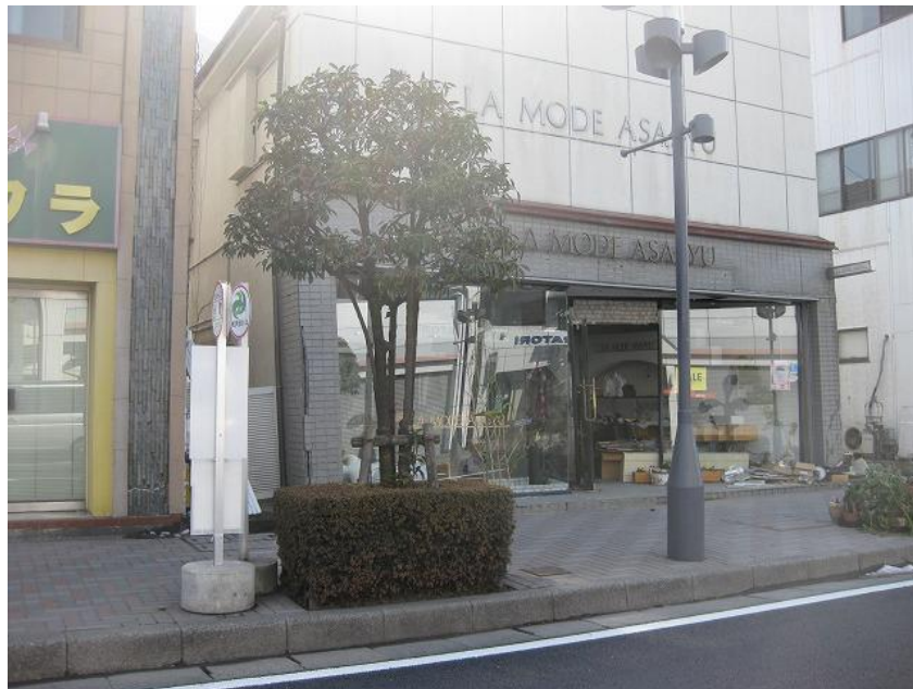
写真 8 2階建て木造店舗併用住宅の傾斜
