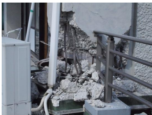
写真 4 東側妻壁南側の外柱の被害状況
