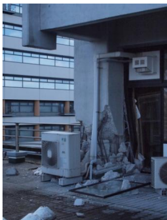
写真 3 東妻壁の北側外柱の被害状況
