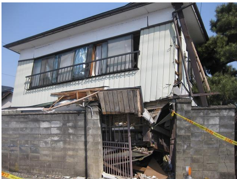
写真 3 2 階建て木造住宅の倒壊
