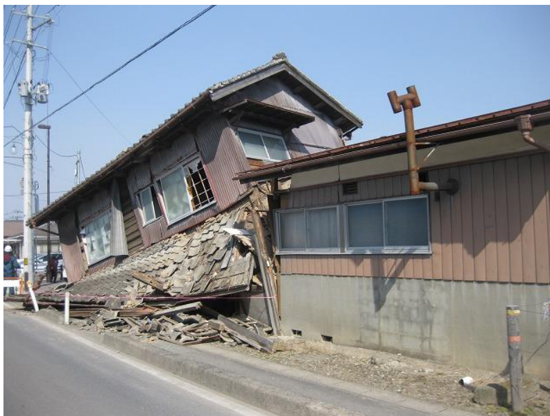
写真 2 2 階建て木造住宅の倒壊
