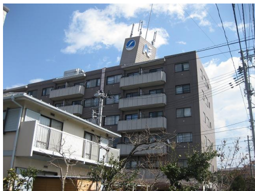
写真5 ペントハウスの被害（若林区成田町）
