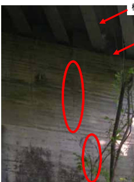
一関側橋台 地震によるものかは不明であるが、橋台中央部に部材軸方向に沿ったひび割れ ( 写真赤丸部 ) が認められる。
