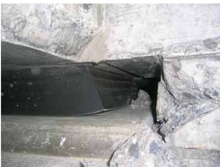
ゴム支承 支承に変形が確認される。また、 支承部周辺にコンクリートの欠け 落ちが見られる。
