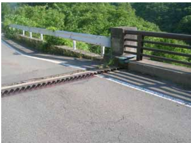
一関側橋台 橋台部伸縮装置に上下方向のずれが生じている。
