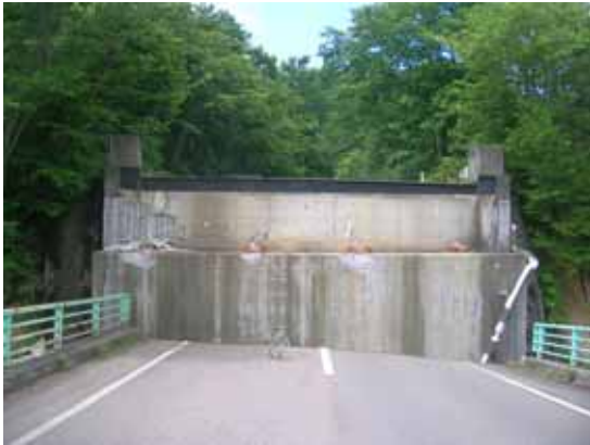
写真7 A1 橋台 . 落橋防止装置は確認されない .
