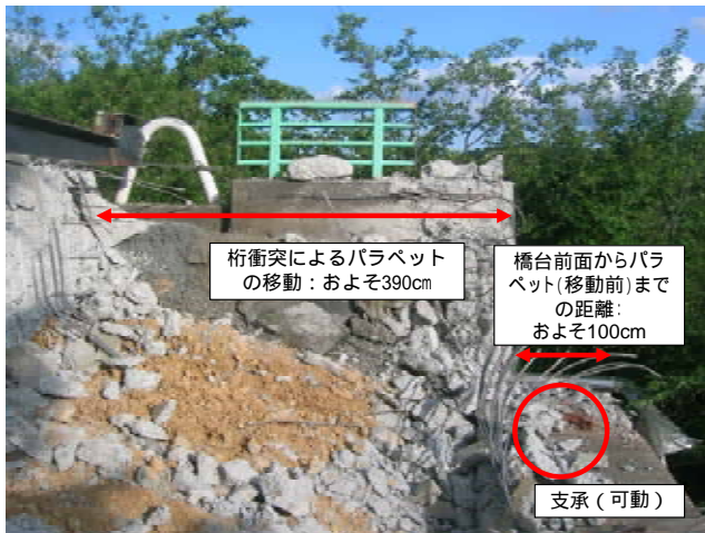
写真2 A2橋台パラベットの移動状況
