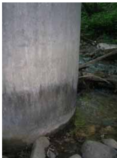
中間 RC 橋脚 右側写真は橋脚基部の拡大写真。 ひび割れ等 地震による損傷は認められない。
