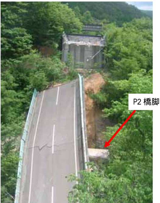
写真8 秋田側から見た落橋状況 . P1 橋脚上から撮影 .
