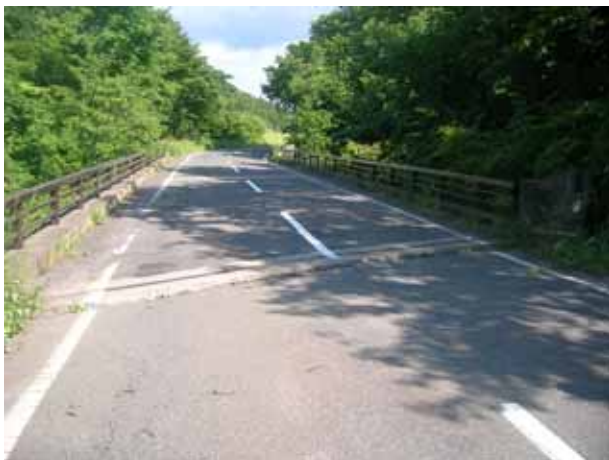
荒沢橋全景 橋台背面部に 5cm 程度の段差が生じているが、 それ以外の損傷は認められなかった。
