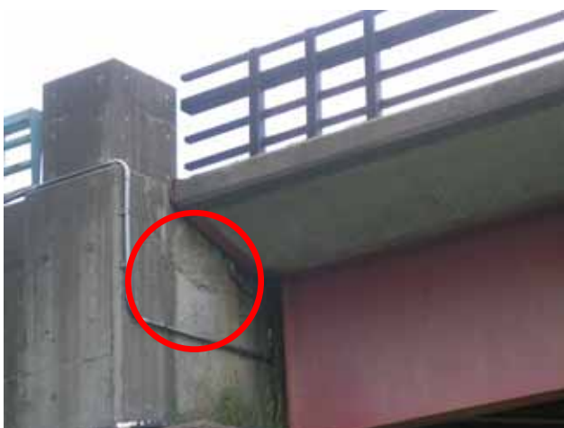
秋田側橋台 赤丸部にひび割れが認められるが、地震による ものかは不明。 なお、秋田側橋台背面部に若干の段差がある。
