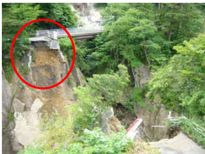
6月17日朝撮影 前日にはあった歩道橋アクセス部(赤丸部)も落ちている。6月16日23時過ぎの余震(一関で震度4)による崩落か？
