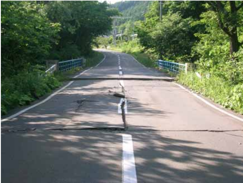
杉の沢橋全景 橋台背面部に 15cm 程度の段差が生じている .
