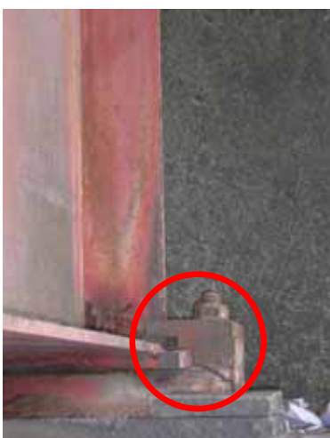
一関側橋台の支承部 赤丸部に支承の割れが認められる。
