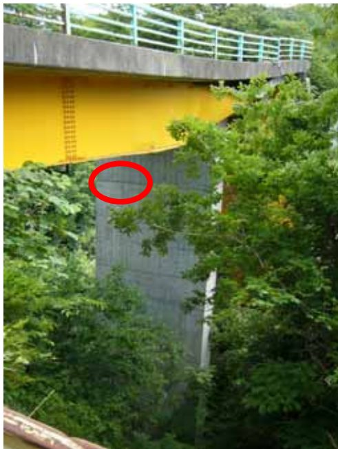
写真 5 P1 橋脚 . 打継目付近 (赤丸部) にひび割れが確認できる
